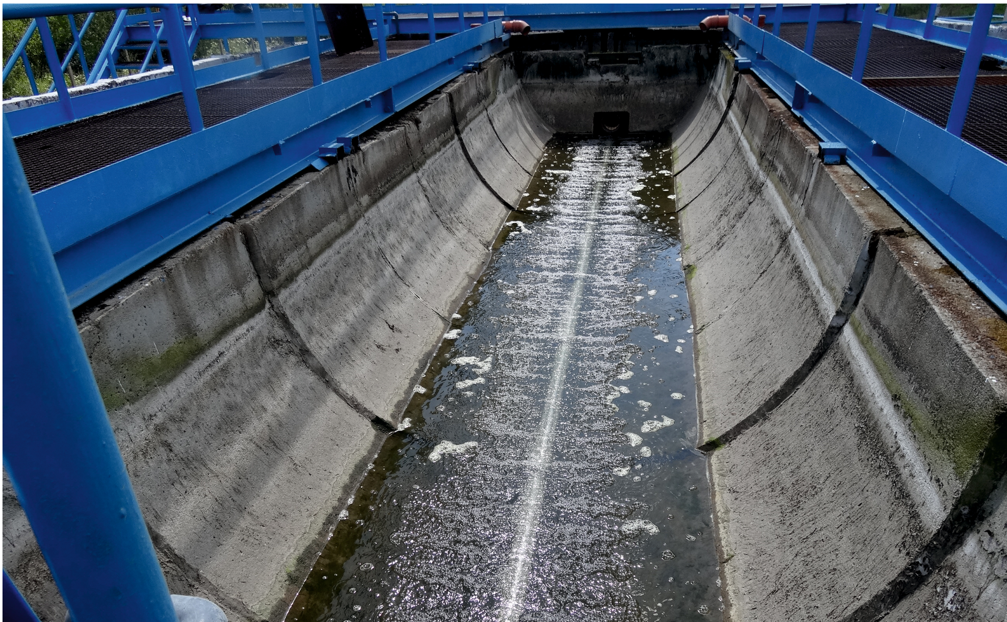
Prevzdušňovanie v nádrži
